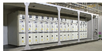
Часть ЗРУ в металлической оболочке
